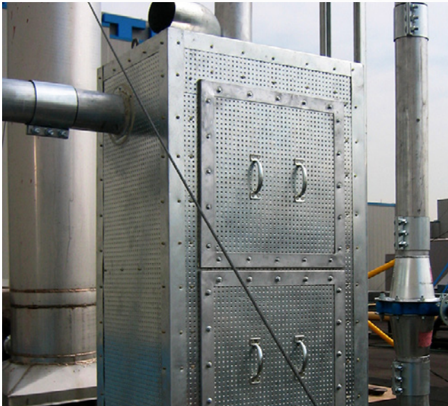
Enceinte pare-souffle pour l'équipement sur le toit.
