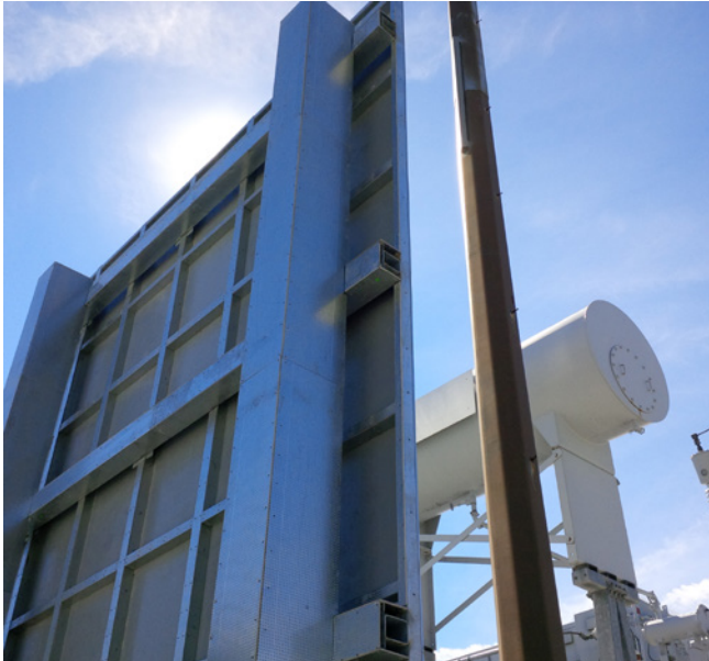
Una instalación de Ballistic DuraBarrier.
