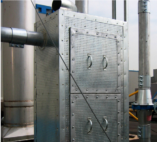
Una caja protectora contra explosiones para equipos en una azotea.
