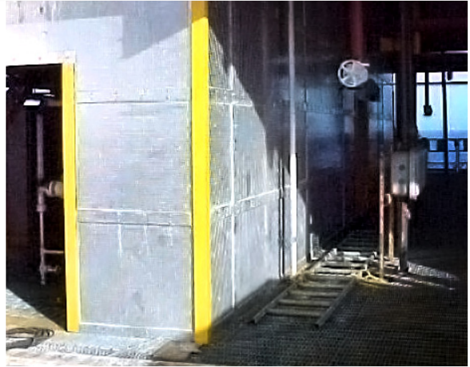
Muro H120 que protege los equipos.
