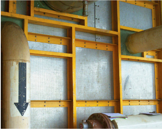
Muro H0 con sellos de penetración de tuberías.
