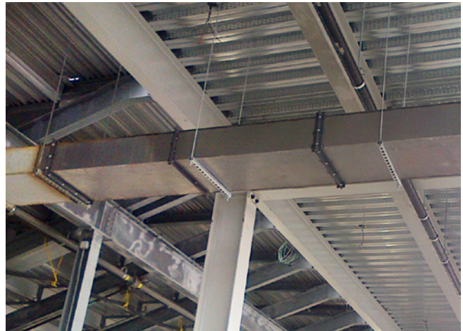
DuraDuct SED conectado a un sistema de extracción existente.
