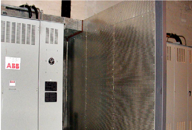
Un mur coupe-feu séparant deux enceintes électriques.
