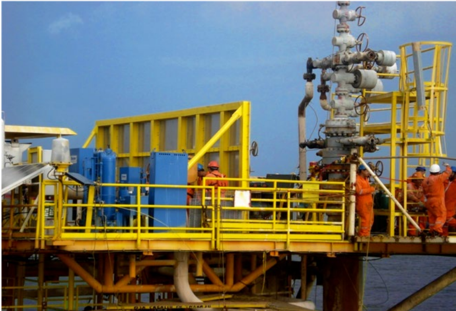
Une paroi séparative DuraBlast protégeant le tableau de commande.
