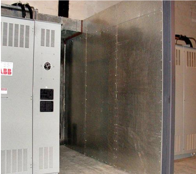
Un muro cortafuego que separa dos cajas protectoras de equipos eléctricos
