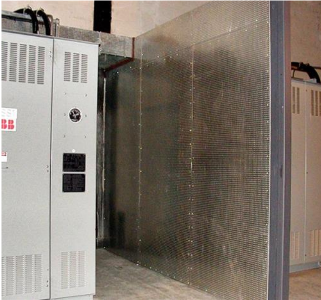
Un mur coupe-feu séparant deux enceintes électriques.
