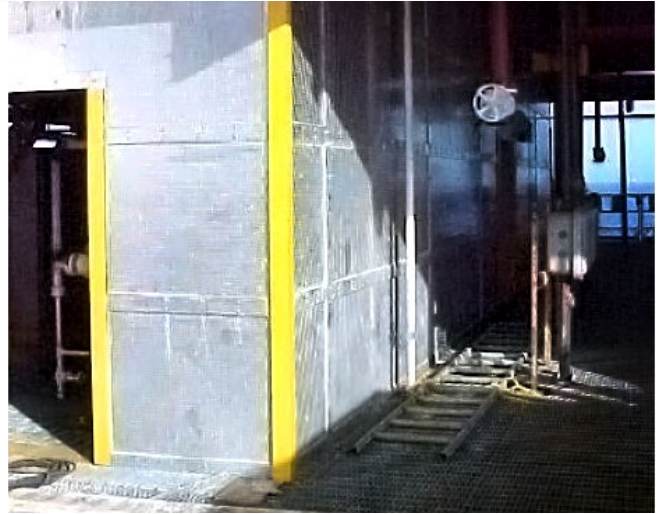
Muro H120 que protege los equipos.
